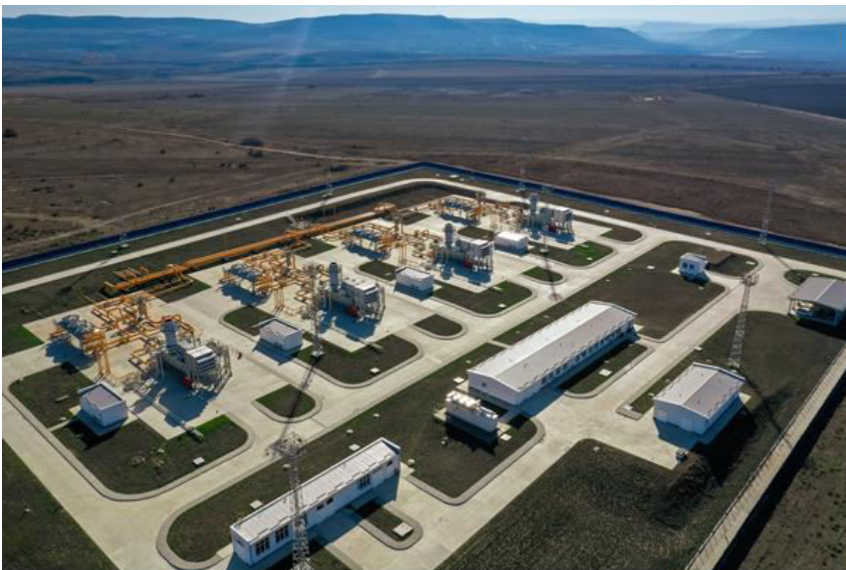
Компресорна станция „Нова Провадия“
